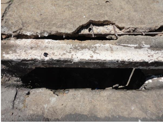
FIGURA 60 – Bueiro com estado de conservação precário na área urbana
