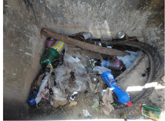
FIGURA 61 – Resíduos encontrados no interior do bueiro
